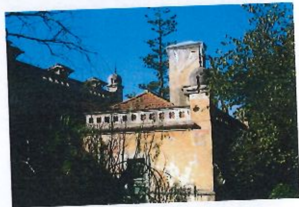
33. Vista parcial do corpo adossado à fachada posterior antes das obras de recuperação (05.11.2014).
