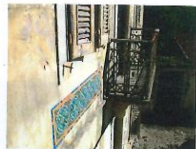
29. Estado de conservação dos azulejos e da guarda da varanda no corpo lateral direito antes das obras de conservação (05.11.2014).
