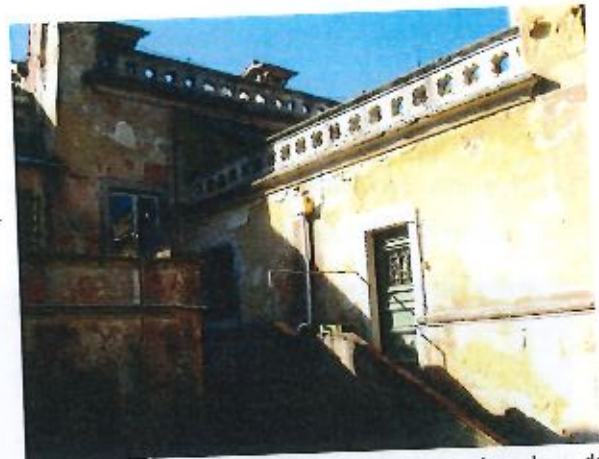
31. Vista parcial da fachada posterior antes das obras de recuperação (05.11.2014).
