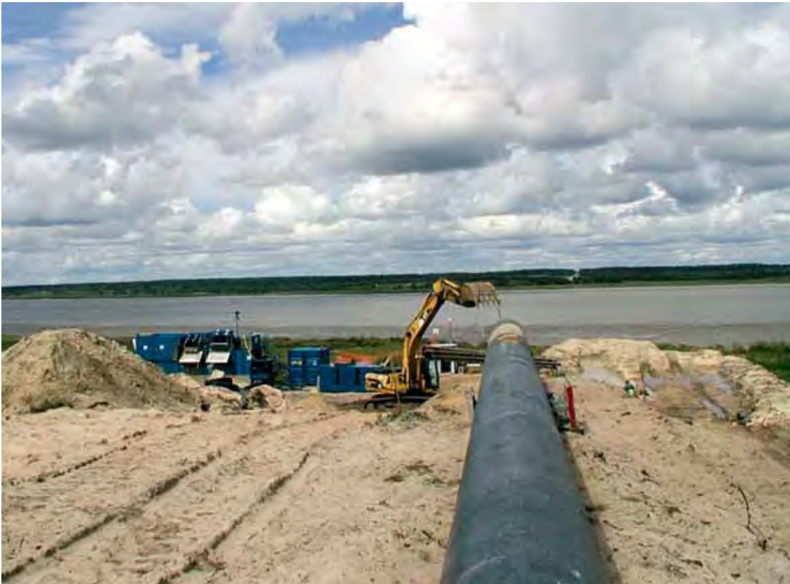
FIG. 13 – Gasoduto Setúbal-Sines. Monte Novo do Sul. 2003.
