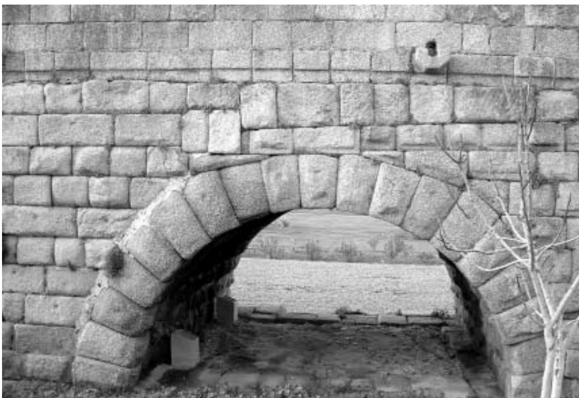
Fig. 16 Arco reformado que sirve de unión con el tercer puente. Cajas de relleno con conglomerado hidráulico.
