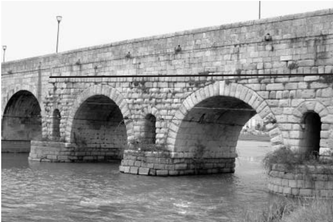
Fig. 12 Arco 19. Detalle de la reforma en el arco para conseguir nivelar el tablero.
