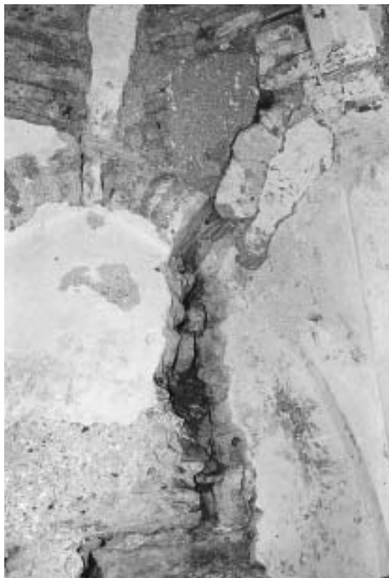
Fig. 14 Ermida do Espírito Santo: identificação dos problemas estruturais no interior da abside.
