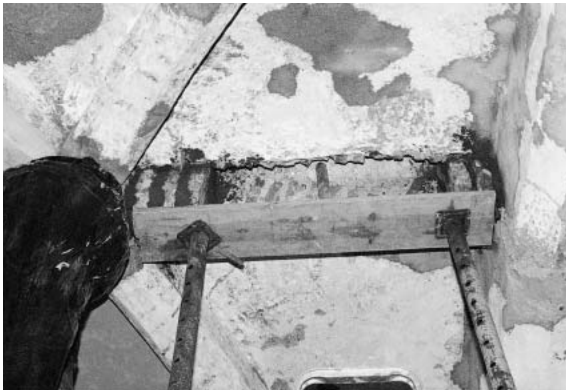
Fig. 17 Ermida do Espírito Santo: remoção e reforço da pequena nervura de fecho com o arco de transição.
