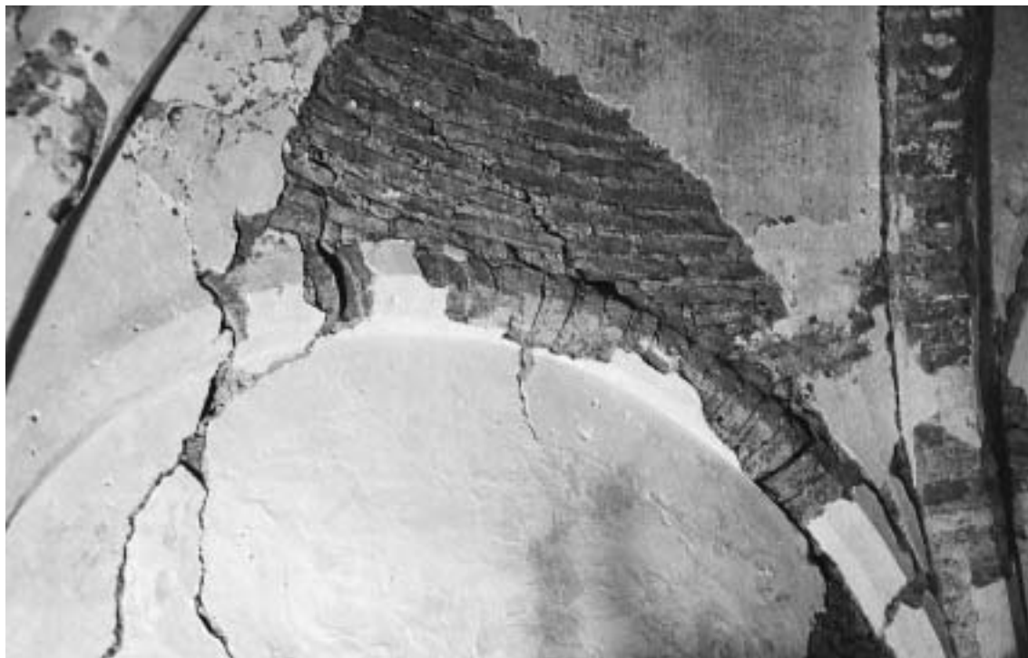
Fig. 13 Ermida do Espírito Santo: pormenor da desagregação do revestimento parietal.
